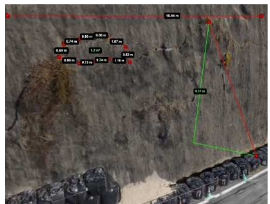
法面変状の定量評価 (さまざまな場所の計測が行える)
